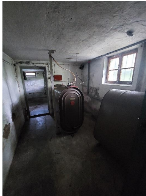
Kellerraum mit Öltanks (leer)
