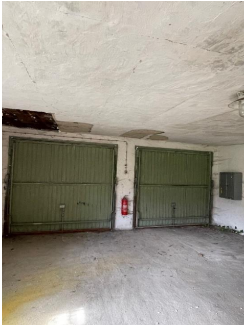
Innenansicht mit Deckenschaden
