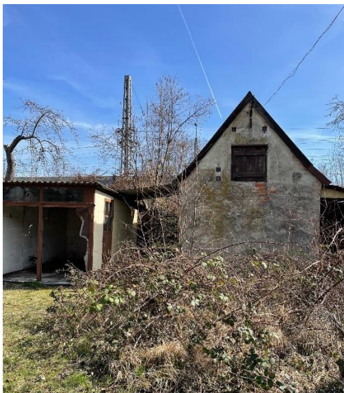
Kleintierstall mit einfacher Garage (baufällig)
