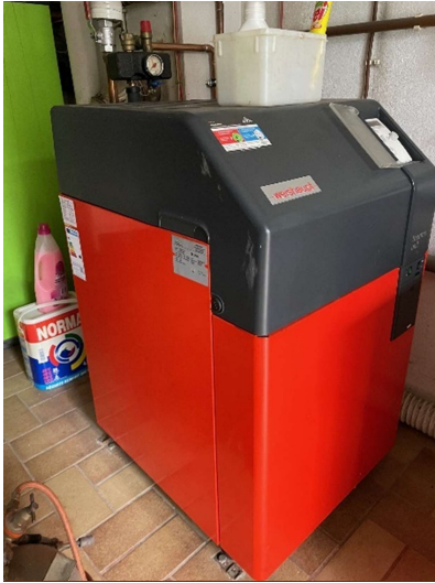
© IMBY: Foto Heizungsraum KG
