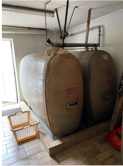
© IMBY: Foto Heizungsraum KG
